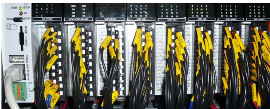
Obrázek 2 Řídící PLC – modulární systém
